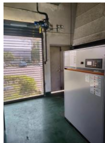
② 高効率コンプレッサーへの更新とコンプレッサー室の通気性改善
