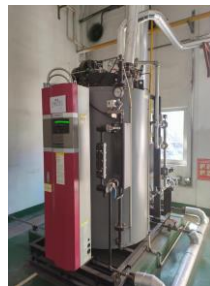
③ 高効率ボイラーへの更新
