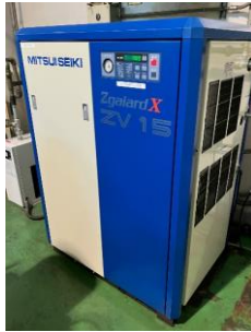
コンプレッサー
